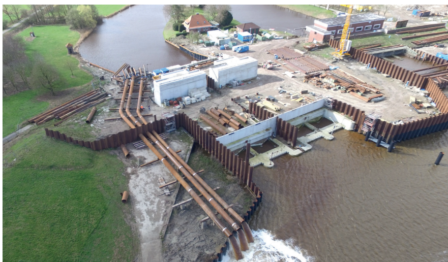
Der Wasserlauf wird über ein Lückmann-Pumpen- und Rohrsystem überbrückt.
